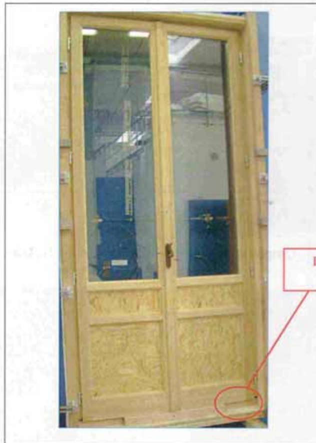
Figura 1: Fotografia del campione in prova: localizzazione dell'area dell'infiltrazione Testing sample's photo: infiltration area
